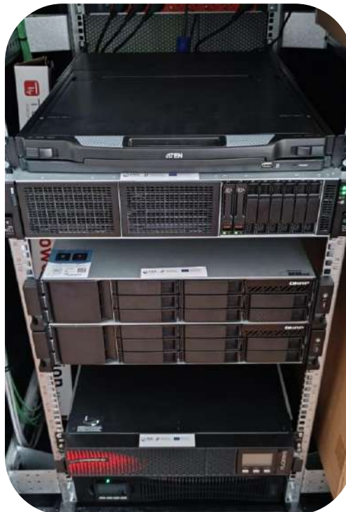
Imagem 6 - Sala de Servidores e Rede Wi-Fi
